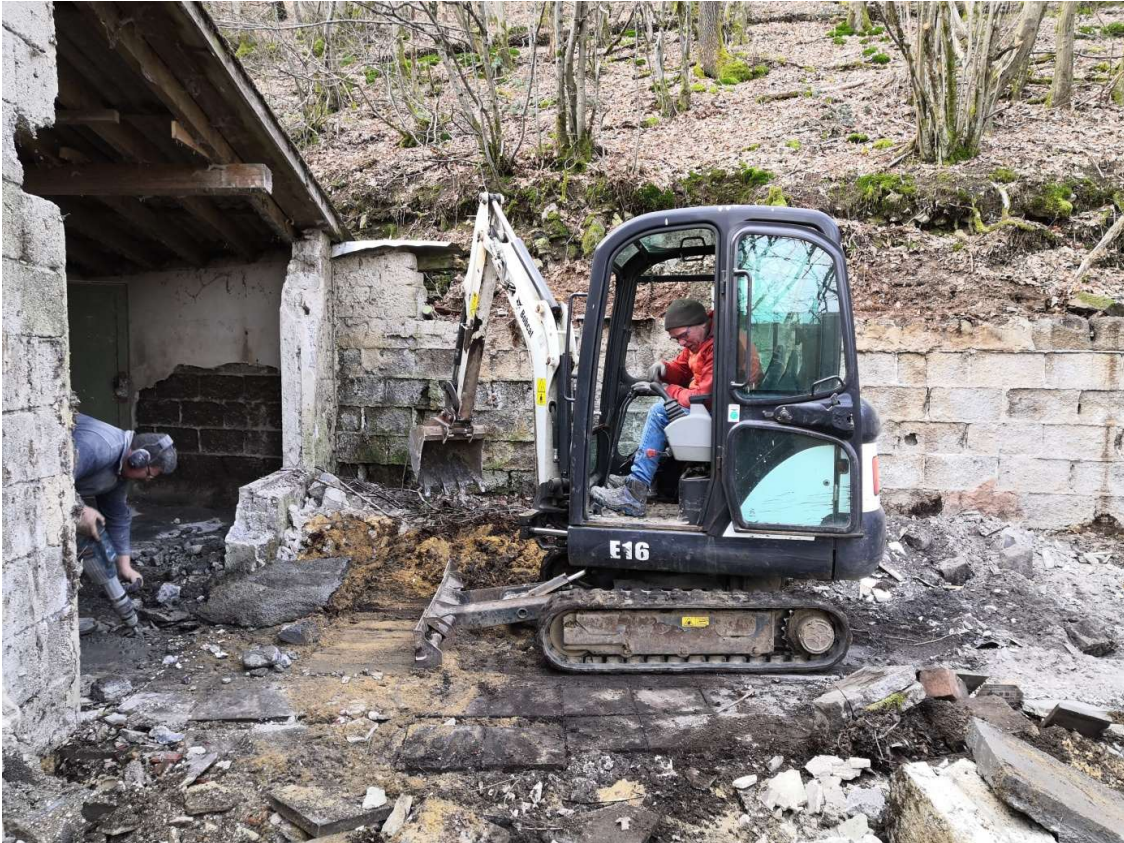
14.03.2020 Marc Hohns und Michael Zimmer bei Abrissarbeiten im Schießstand. Foto: Frank Marten
