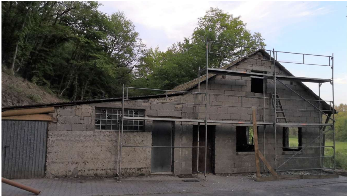
08.05.2020 Ansicht nach der Demontage der Holzbretter Man erkennt die neu abgemauerten Fensteröffnungen. Foto: Lothar Krupp
