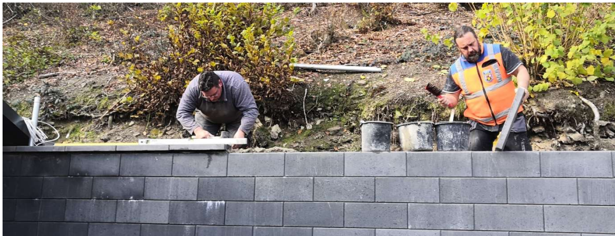
( 14.11.2020 Marc Hohns und Jan Daniel beim setzen der Abdecksteine auf der Schalsteinmauer. Foto: Frank Marten)
