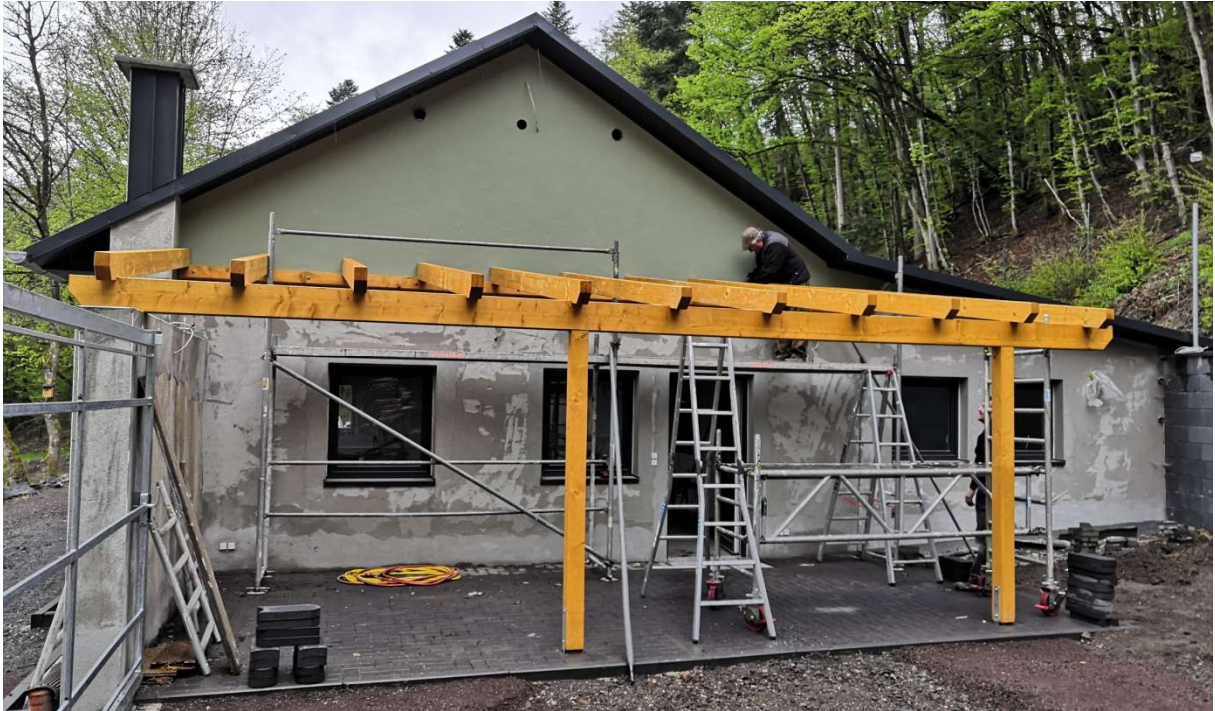
15.05.2021 Lothar Krupp beim aufschlagen seines gewerkten Dachüberstandes über der Terrasse im alten Schießstand. Foto: Frank Marten
