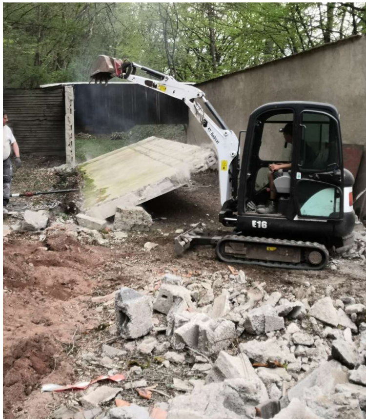
18.04.2020 Fall der hinteren Pistolenmauer. Links Mark Hohns, im Bagger Maximilian Lenerz. Foto: Frank Marten
