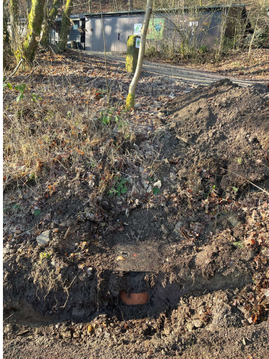
Beim ausschachten hatten wir den Revisionschacht vom Abfluß gefunden. Dieser ist für das Gebäude vom Eifelverein und das Angelerheim. Foto: Frank Marten
