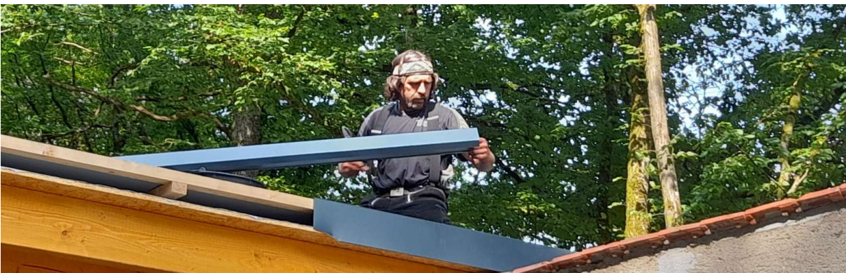
23.07.2021 Marco Heck (Schwarzen) beim montieren der Ortbleche am Schleppehdach. Foto: Lothar Krupp
