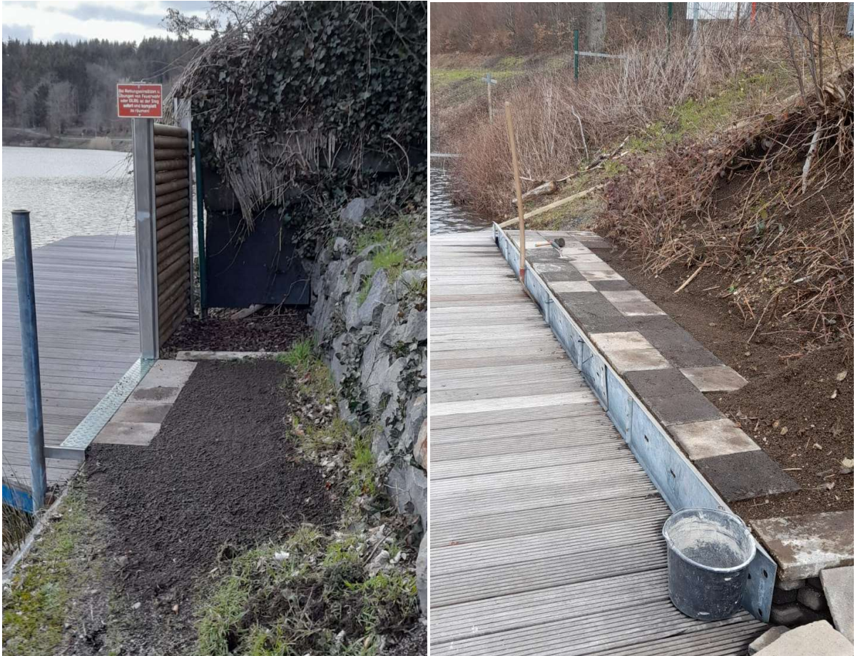
15.03.2020 Die alten Betonplatten, vom altem Schützenhaus, wurden am Rettungssteg am Pulvermaar verbaut und werden wieder weiter genutzt. Foto: Lothar Krupp
