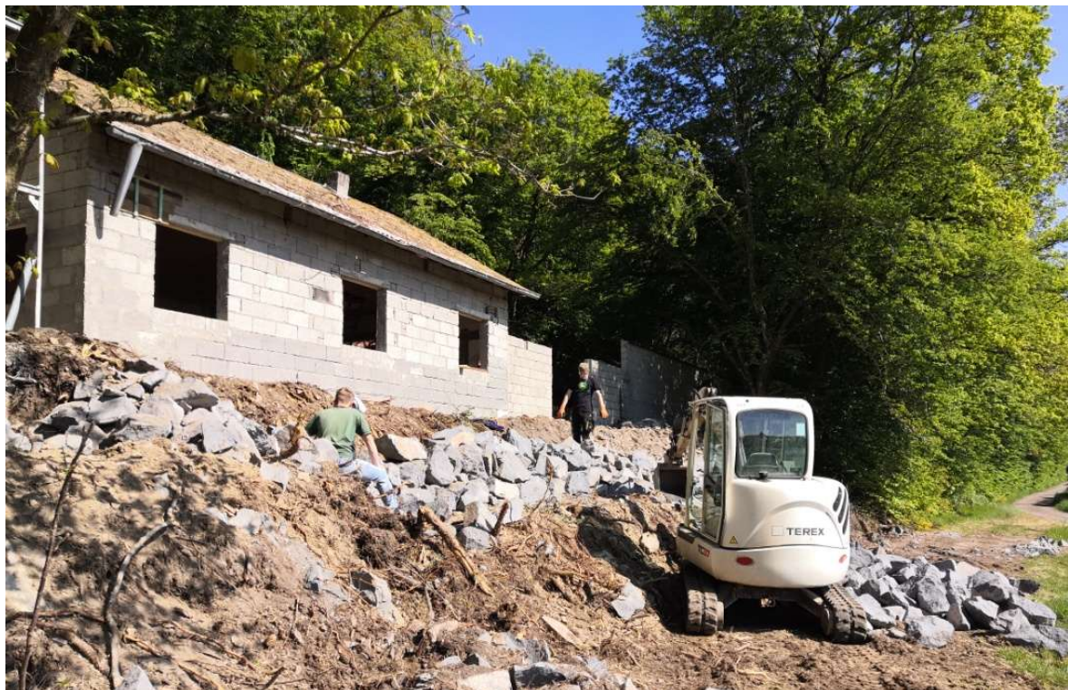
16.05.2020 Jonas Zimmer und Marius Römer beim bau der Trockenmauer. Foto: Frank Marten
