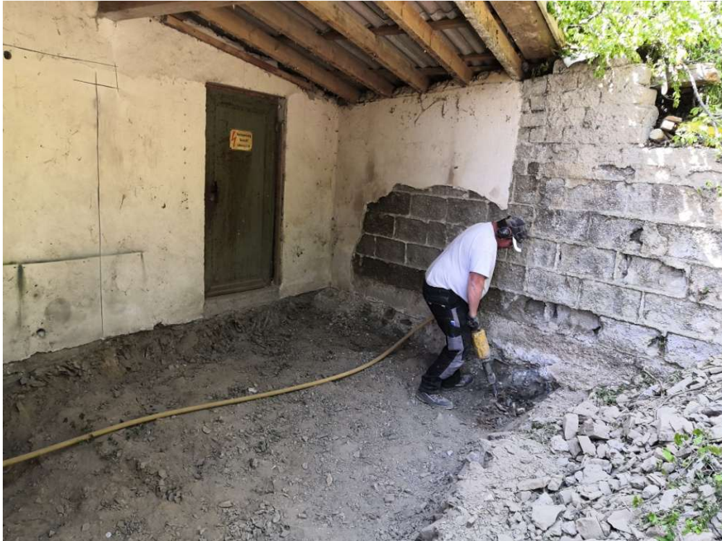
25.04.2020 Mark Hohns bei den Ausschachtarbeiten am Fels für den Unterbau des Küchenbodens mit dem Baukompressor. Foto: Frank Marten
