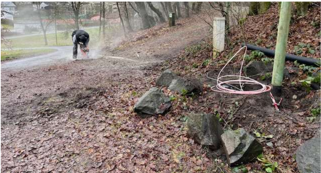
Maik Thome beim einschneiden der Teerdecke der Zufahrt für den Eifelverein. Hier soll die untere Straßenlampe noch mit angeschlossen werden. An der Lampe erkennt man das Glasfaserleerrohr. Foto: Frank Marten
