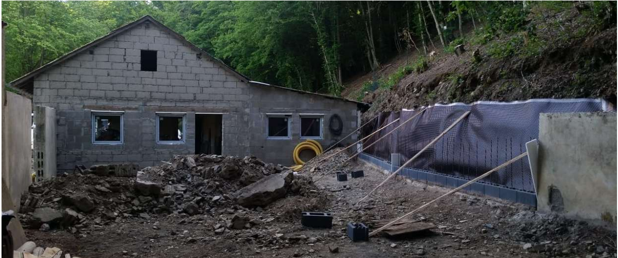
02.06.2020 Vorbereitung der Noppenbahn für den Bau der Schalsteinmauer. Die Drainage ist schon hinter der Noppenbahn verlegt. Die Moniereisen wurden alle ins vorhandene Fundament eingbohrt. Im Gebäude sind alle neuen Fenster eingesetzt. Foto: Frank Marten
