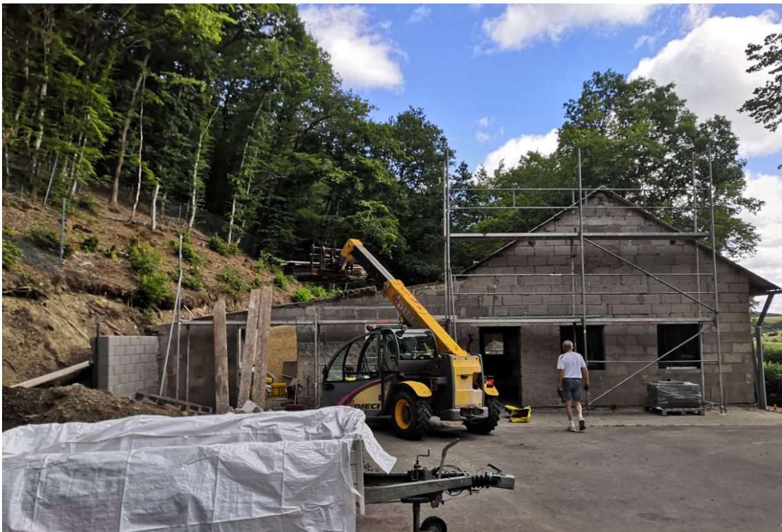
03.07.2020 Demontage des alten Dach mit der Hilfe des Teleskoplader von Geddy Lenerz. Rechts Michael Zimmer. Foto: Frank Marten
