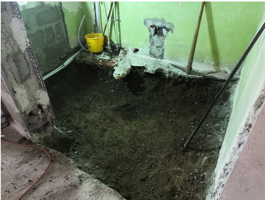
10.08.2020 Der Boden in der Spülküche musste auch noch erneuert werden. Auch hier war keine feste Bodenplatte eingebaut. Unter den neuen Beton kam Lava. Foto: Frank Marten
