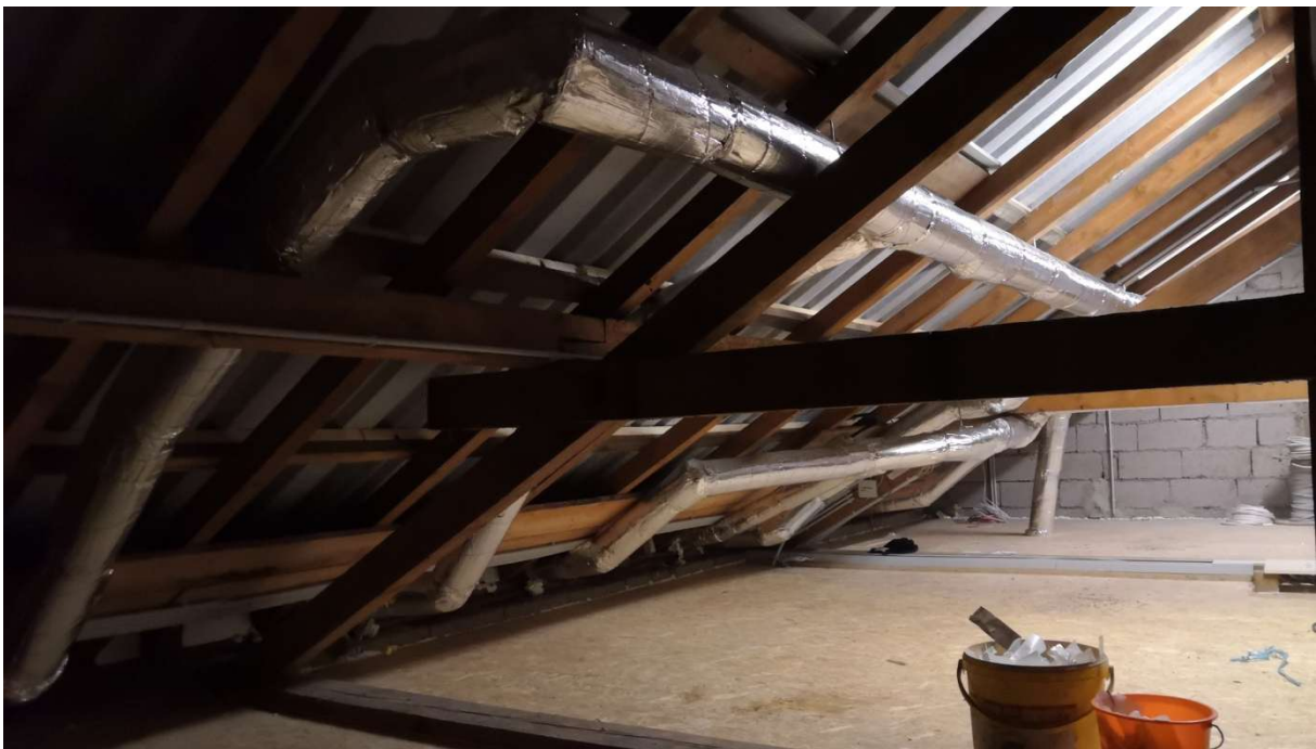
04.01.2021 Die fertig montierte Raumlüftungsanlage des Anglerheim. Foto: Frank Marten
