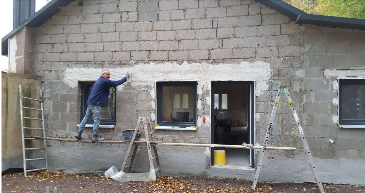
07.10.2020 Michael Zimmer bei Vorbereitungsarbeiten für den Außenputz an der Fassade zum Schießstand. Foto: Lothar Krupp
