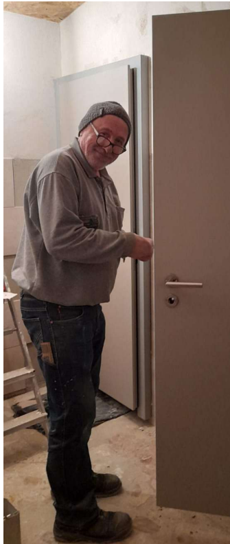
03.02.2021 Reiner Görres beim montieren der WC- Türen. Die Türzargen wurden von Reiner auf Maß angefertigt, da es hier nicht möglich war handelsübliche Türzargen zu verbauen. Foto: Lothar Krupp
