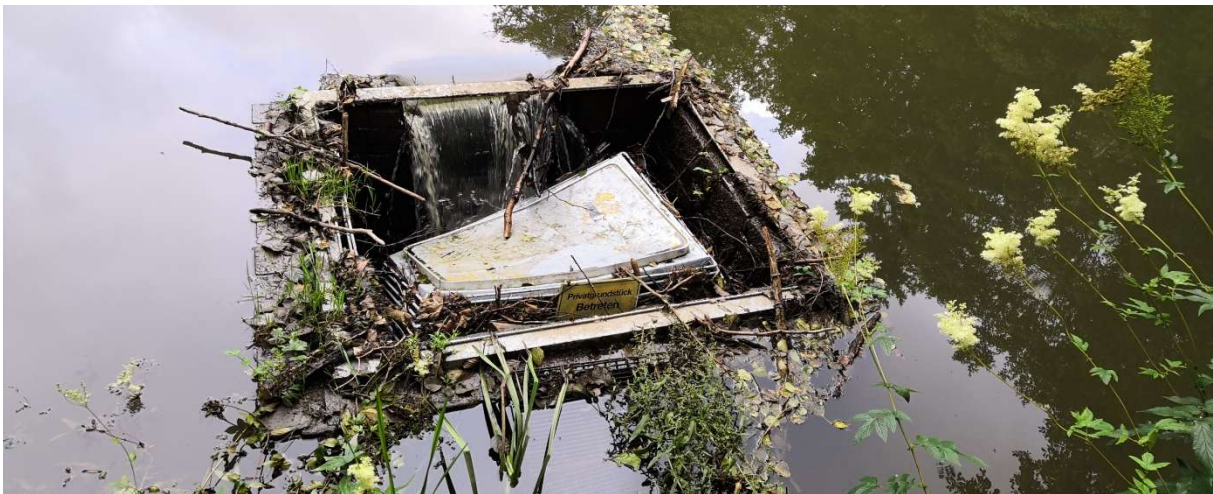
07.08.2021 Durch die starken Niederschläge (Gillenfeld hatte 64Ltr.), die am 14.07.2021 zur Hochwasserkatastrophe an der Ahr, Erft, Kyll, und Nims führten, wurde auch die Sammetbach so hoch geflutet, dass der Stahlschutz auf dem Mönch im Weiher von den Wassermassen vollkommen zerstört wurde. Foto: Frank Marten
