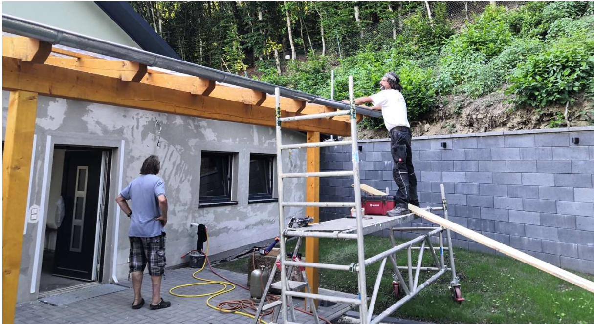
16.06.2021 Marco Heck (Schwarzen) beim montieren der Scobalitplatten auf der Terrassenüberdachung. Unter dem Terrassendach steht Wolfgang Thiel. Foto: Frank Marten
