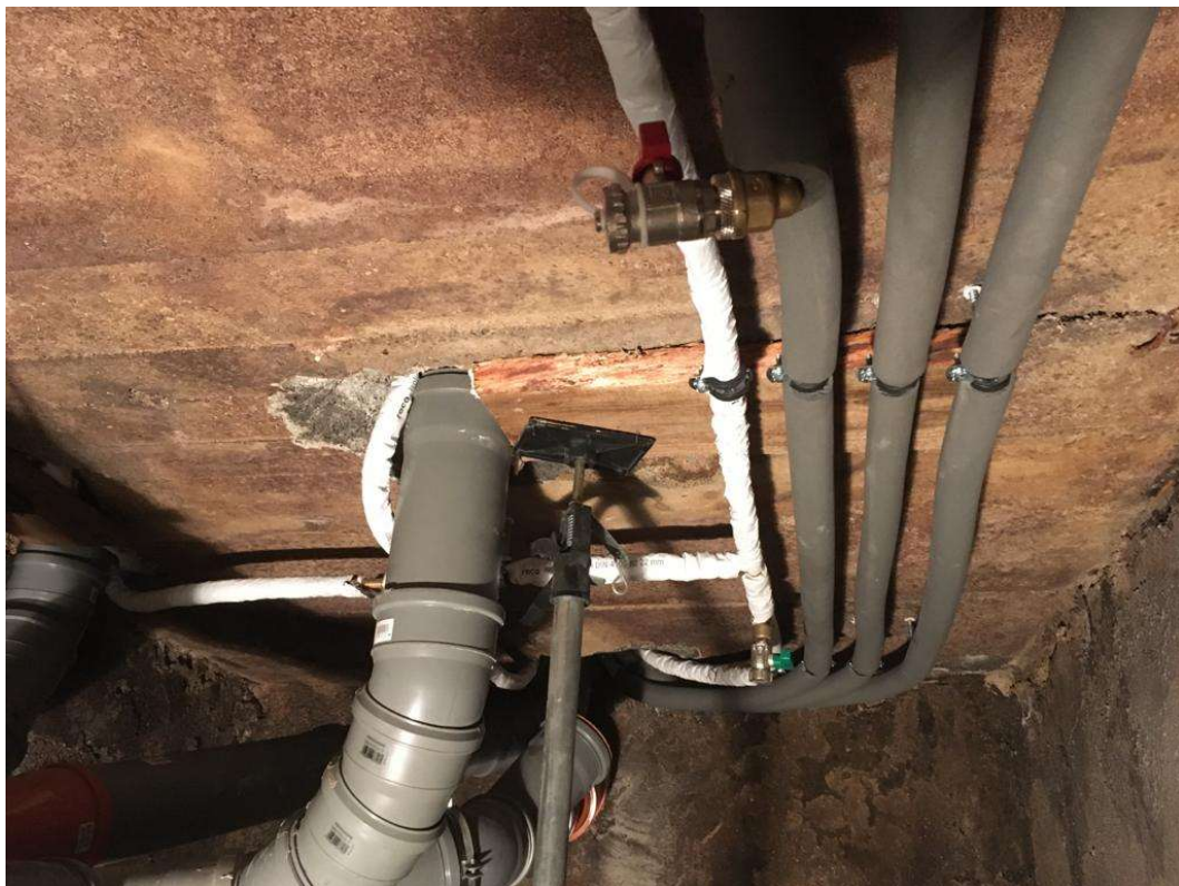
15.08.2020 Rohrleitungen in der Klärgrube. Foto: Frank Marten
